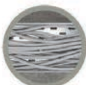
Cheminements de câbles
