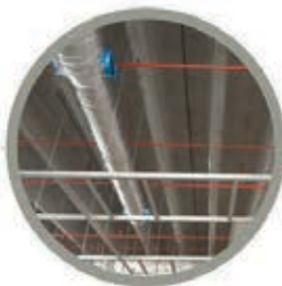
Ventilation et air conditionné
